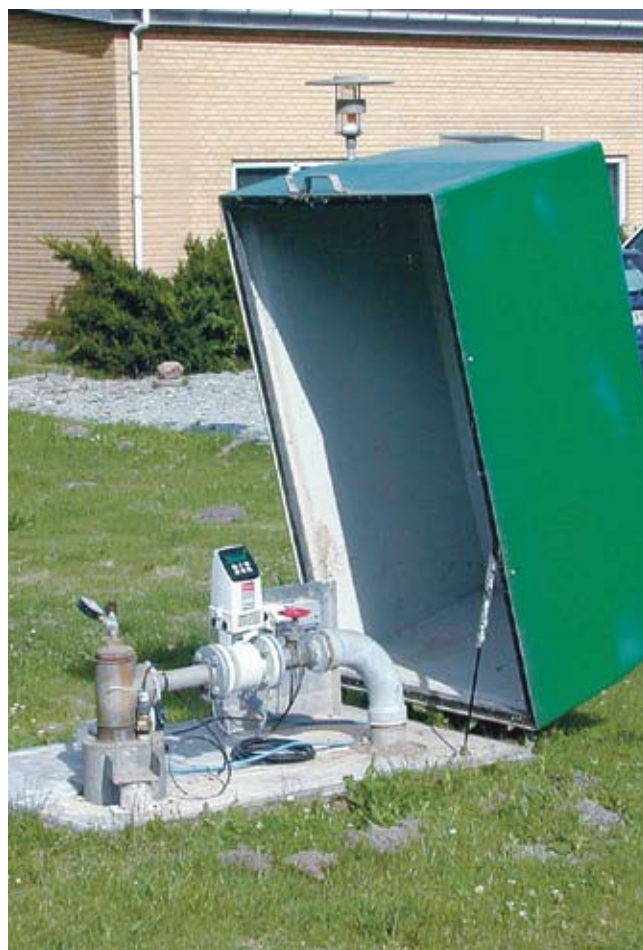
Boringerne med pumpeværkerne er gemt bag der grønne kasser, hvoraf en her er lukket op. Billede fra 2005.
